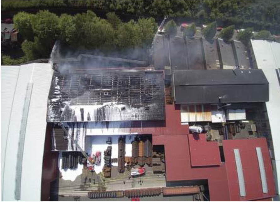
Drohneinsatz an einer einsturzgefährdeten Halle.
